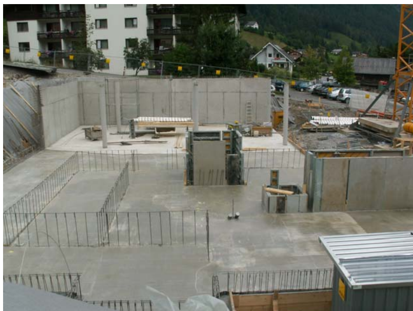
Keller Talstation „Dorfbahn“
